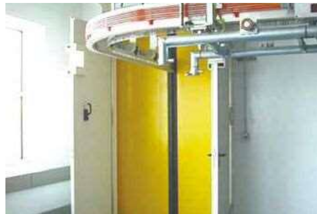
クレーンレール部分の切欠き 窓無し
